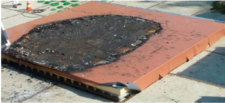
Fig. 5a Campione isolato con PIR Area superficiale danneggiata dopo la rimozione dei pannelli fotovoltaici
