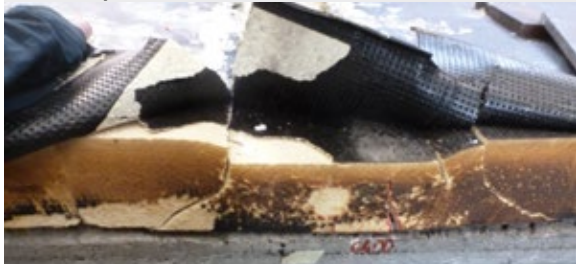
Figura 18. Campioni alveolari: particolare della rottura localizzata diretta del pannello isolante.
