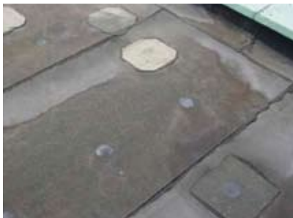
Fig. 1 esempio di copertura danneggiata
