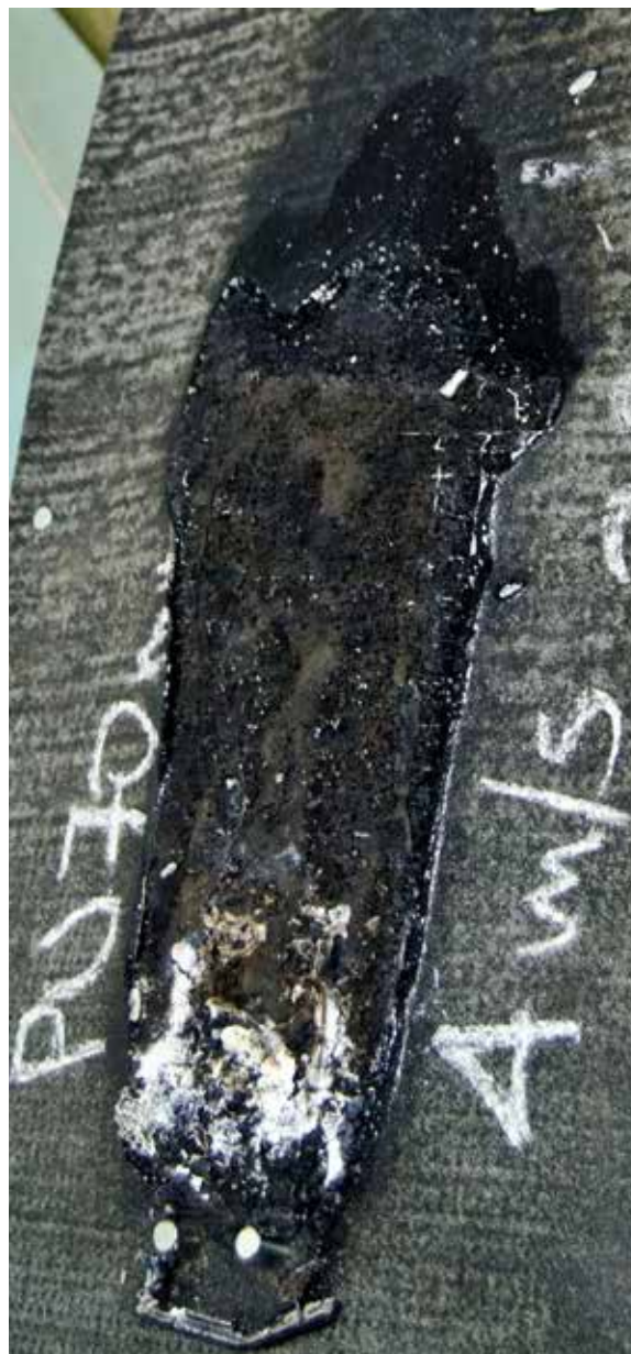
Un particolare della carbonizzazione superficiale dello strato isolante in poliuretano posto al di sotto del manto impermeabile.
