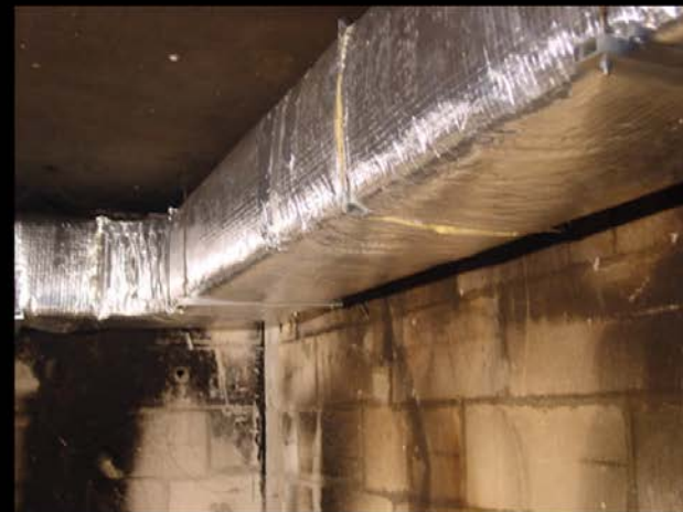
Canale in lamiera isolato con lana minerale rivestita in carta alluminata
